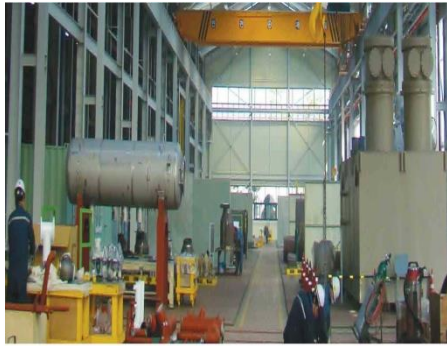
<Skid Module Part>
